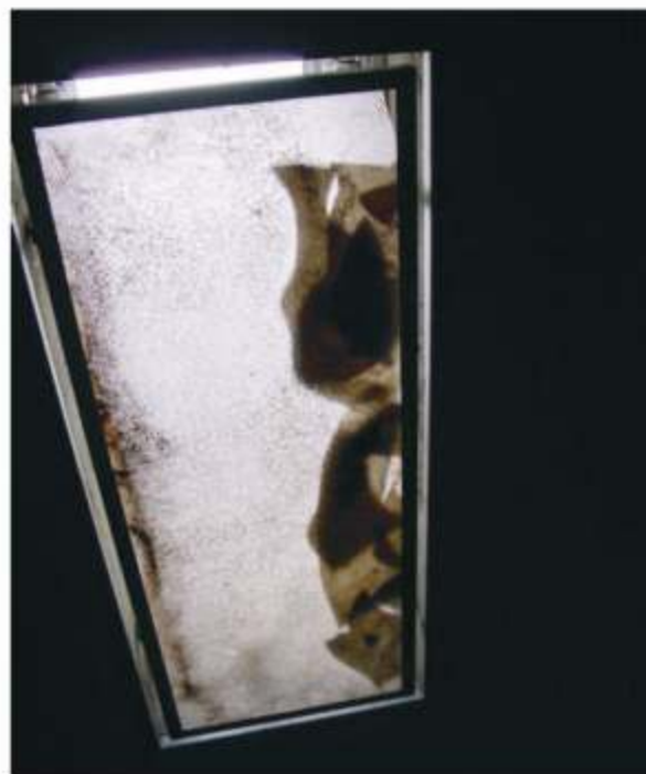
Figura 7. Falta de mantenimiento en luminarios.
