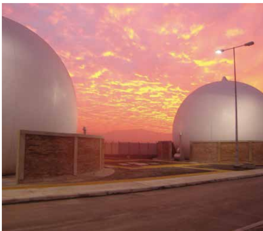
FIGURA 2. GASÓMETROS DEL SISTEMA DE BIOGÁS EN LA PTAR CCU CHILE
