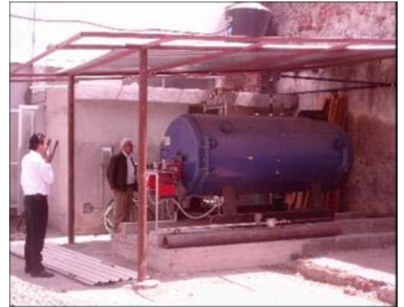
Imagen del compresor empleado en la fabrica de quesos del Grupo San Diego, La Blanca
