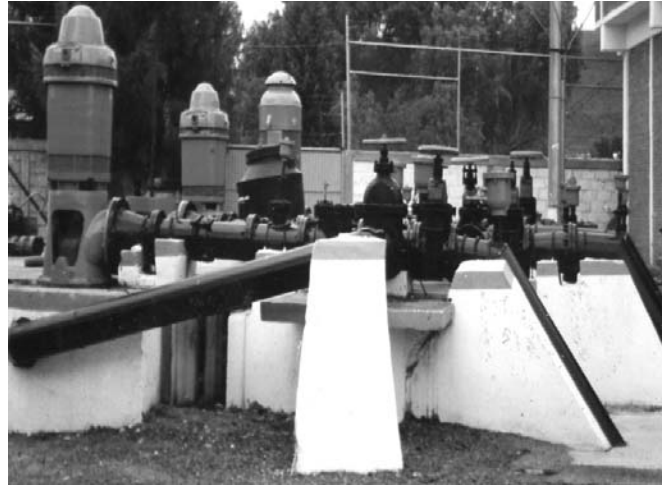
Equipos de bombeo.
